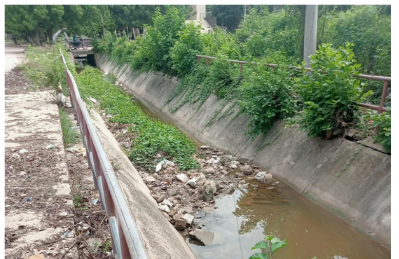
Los sedimentos y otros elementos en los canales pueden dificultar el flujo normal del agua.
