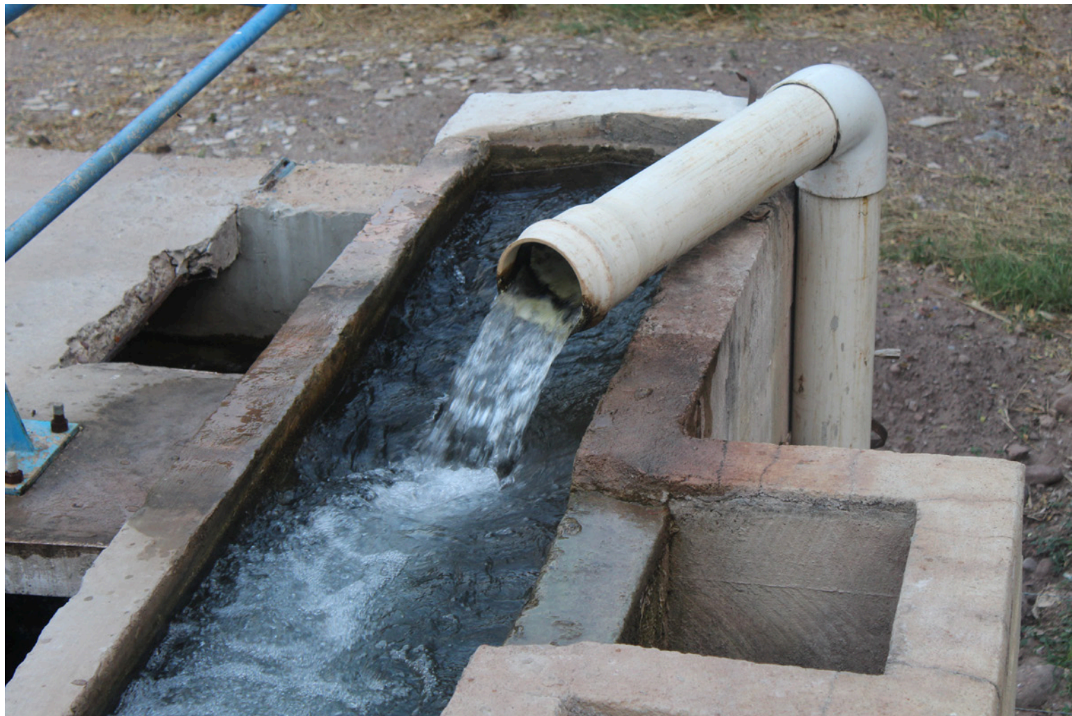
Servicio de agua potable y saneamiento básico en varios municipios del sur.
