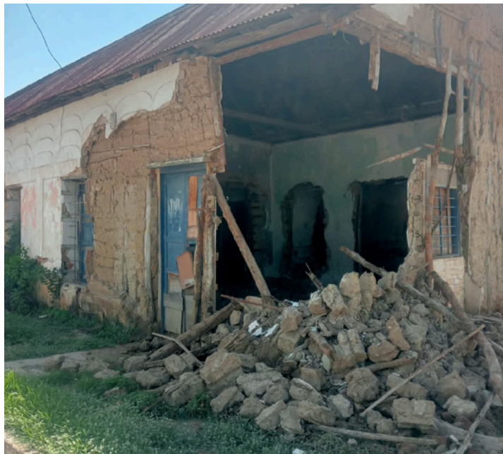
La situación genera preocupación entre los vecinos, quienes temen que el inmueble termine desplomándose.
