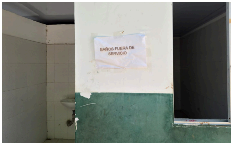
El daño de los sanitarios no es reciente, por lo que expresaron su preocupación ante la continuidad.
