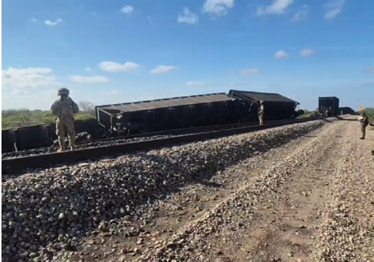
En la acción terrorista no se reportaron personas heridas, solo daños estructurales en la línea férrea.
