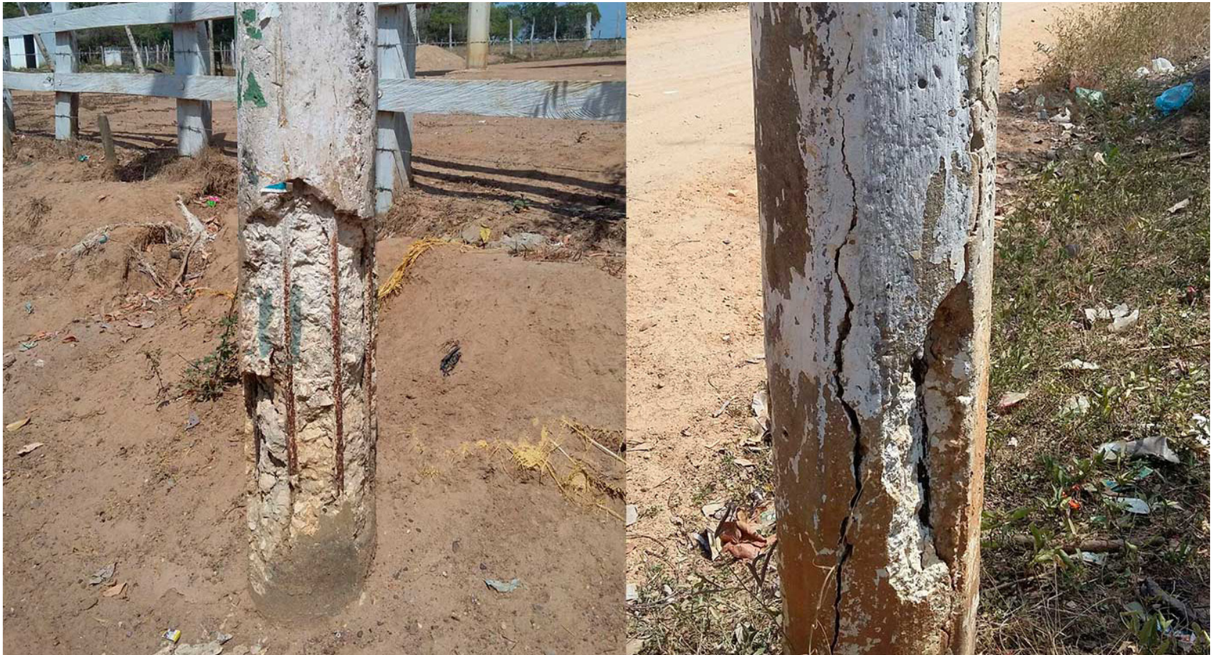
Las grietas del poste son discontinuidades, como las de un sistema que nos tiene sometidos a suspensiones cada vez más frecuentes.
