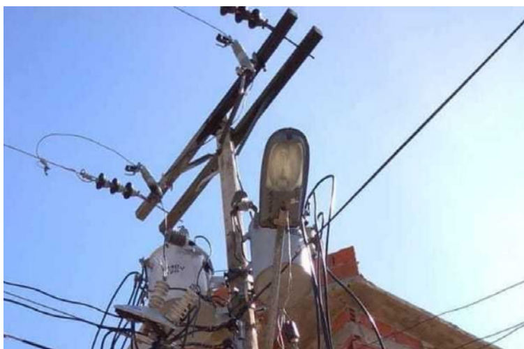
Los daños en transformadores que nos dejan a oscuras durante días ya son parte del paisaje guajiro.
