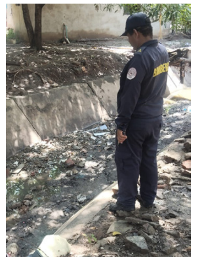
Los drenajes son necesarios para evitar emergencias.
