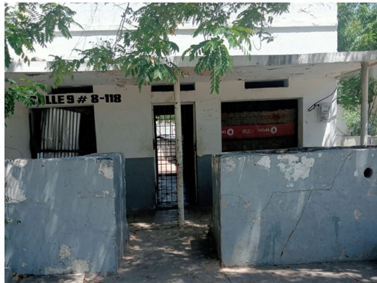
Las autoridades deben definir qué acciones se adelantarán para evitar que continúe su deterioro.
