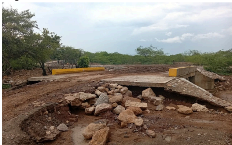
Las lluvias mantienen a los habitantes de esta zona rural prácticamente incomunicados.
