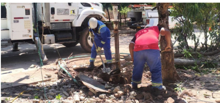
La compañía realizó las labores necesarias para solucionar la situación y reducir el riesgo para los residentes.
