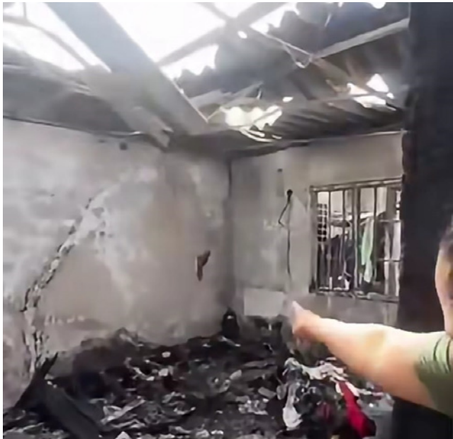
Luego de haber llegado la energía e intentar conectar un ventilador se originó un cortocircuito.
