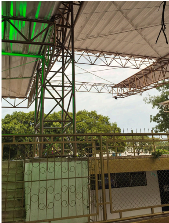
La fundación se reunió en pleno para mirar y evaluar los daños en la estructura.
