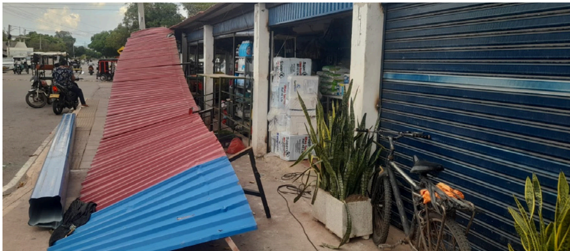
El fenómeno natural provocó el desprendimiento y caída del techo o 'cachucha'.
