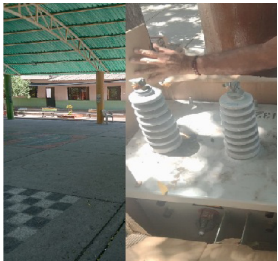
El transformador llegó al colegio Villa Luz en diciembre del año pasado.
