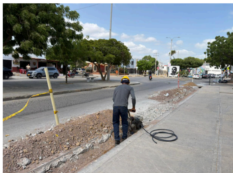
Se informó que en la zona se instalarán más de 5.500 metros lineales de tubería PVC nueva.
