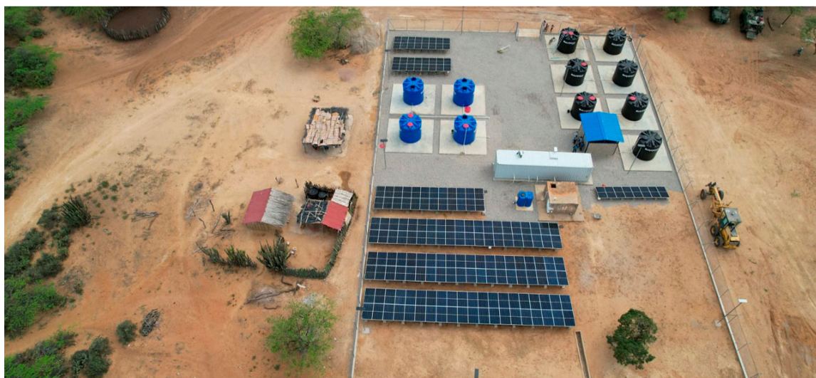
La Ptap tendrá una capacidad de producción cercana a los 80.000 litros diarios.
