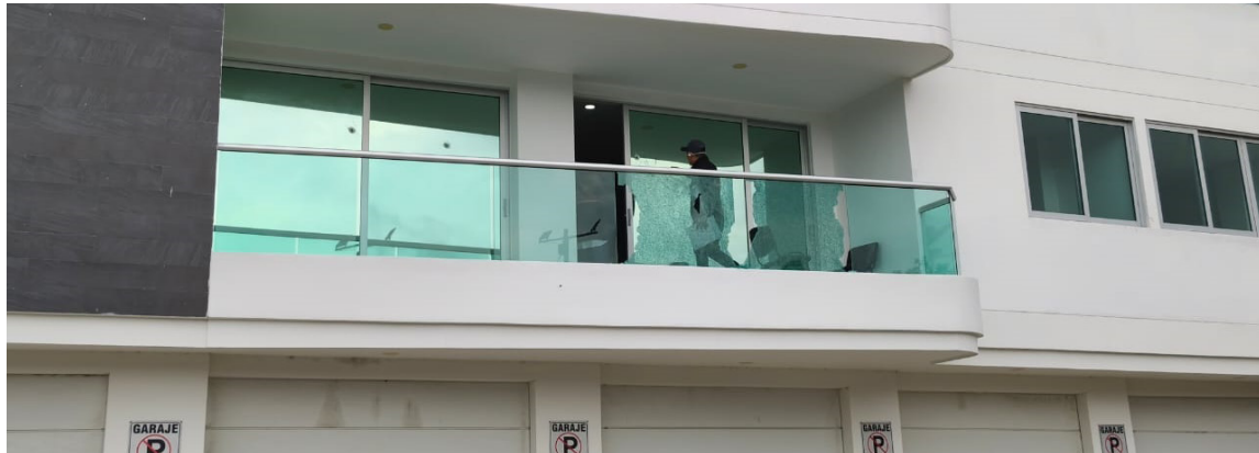
Los disparos ocasionaron daños materiales en los vidrios de la terraza.
