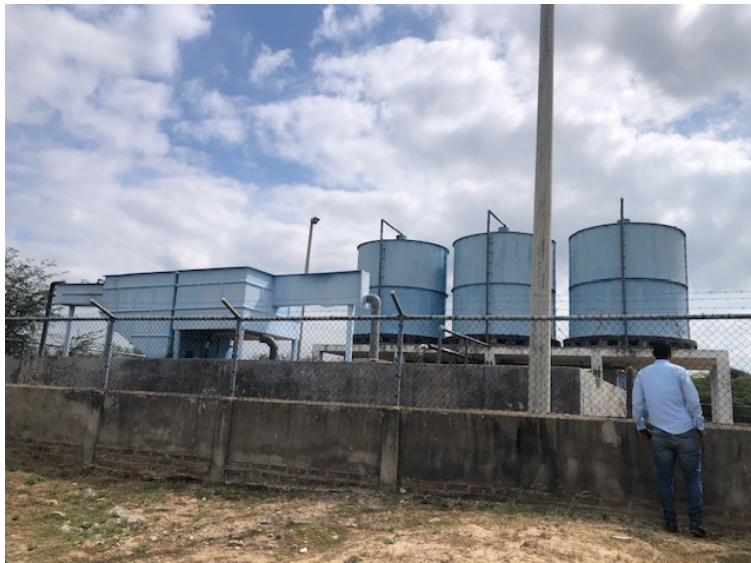
Planta de tratamiento del corregimiento de Camarones.
