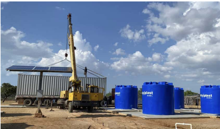
Todo el funcionamiento del sistema desde la extracción, potabilización y entrega final es con energía solar.
