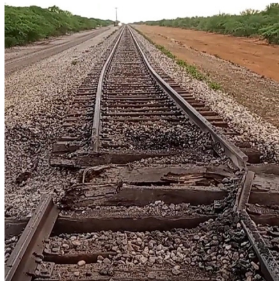
Atentan contra la línea férrea del Cerrejón que transporta carbón a Puerto Bolívar.
