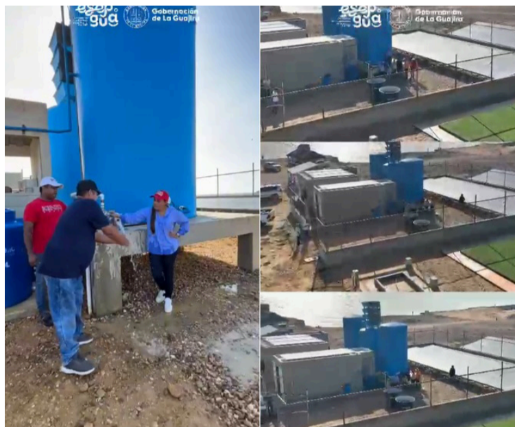
El líquido que reciben las familias proviene directamente del proceso de desalinización y potabilización de la planta.
