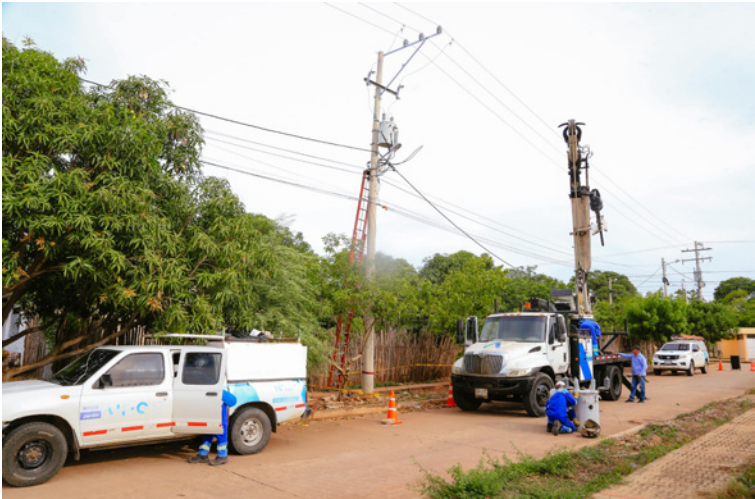
En total, se aumentó en 75 kilovatios la capacidad instalada en la urbanización San Benito.
