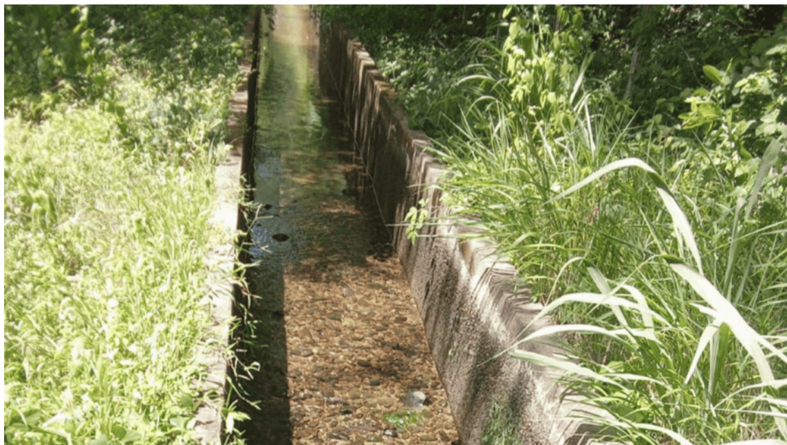
El cierre del paso en la zona de captación ha interrumpido por completo el ingreso de agua cruda a la planta.
