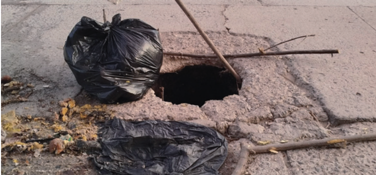
Las alcantarillas sin tapa siguen causando mal olor en el municipio y generando peligro para los ciudadanos.
