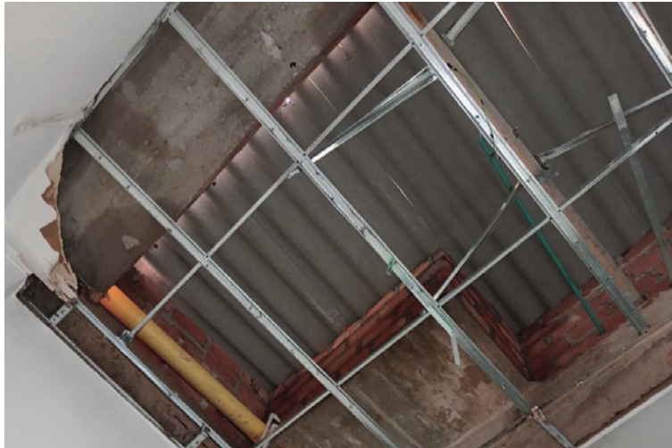
Las lluvias afectaron el cielo raso y también imágenes religiosas en el interior del recinto.
