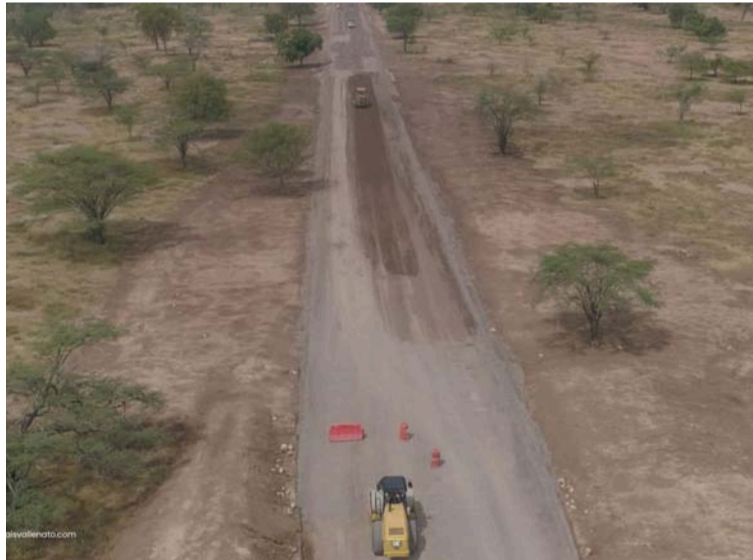
Según las quejas, la obra no cumple con la seguridad vial correspondiente para la integridad de los ciudadanos.
