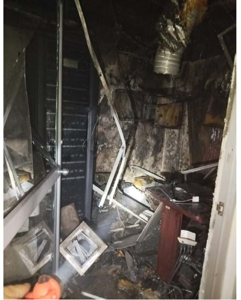
El incendio solo dejó daños estructurales, sin víctimas lesionadas, según el informe de los bomberos.
