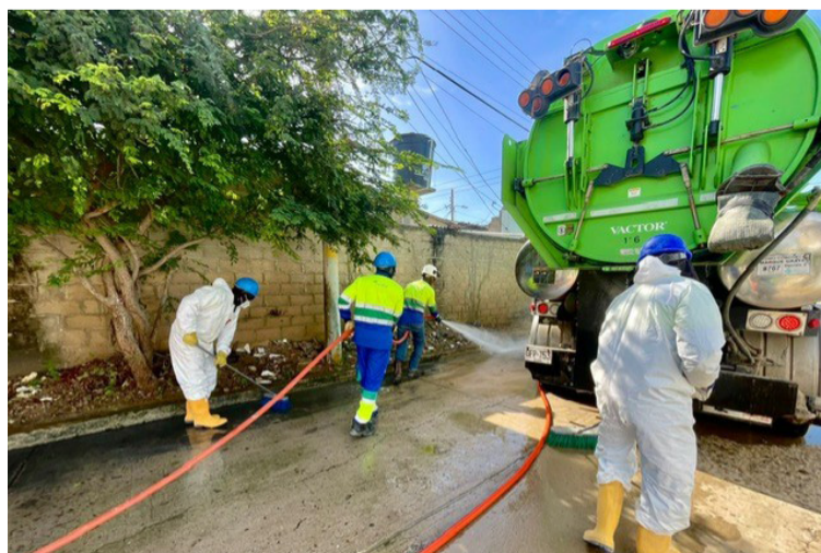
El colector recogía y transportaba aproximadamente el 46% de las aguas residuales de la ciudad.
