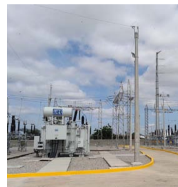
Se hará mantenimiento a un transformador.
