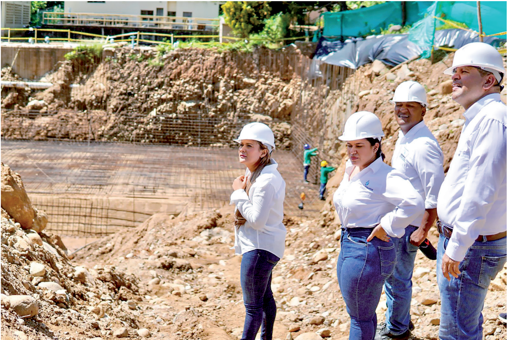
La gerente de Esepgua, Andreína García, afirma que esta intervención beneficiará a cerca de 5.800 habitantes en el casco urbano.
