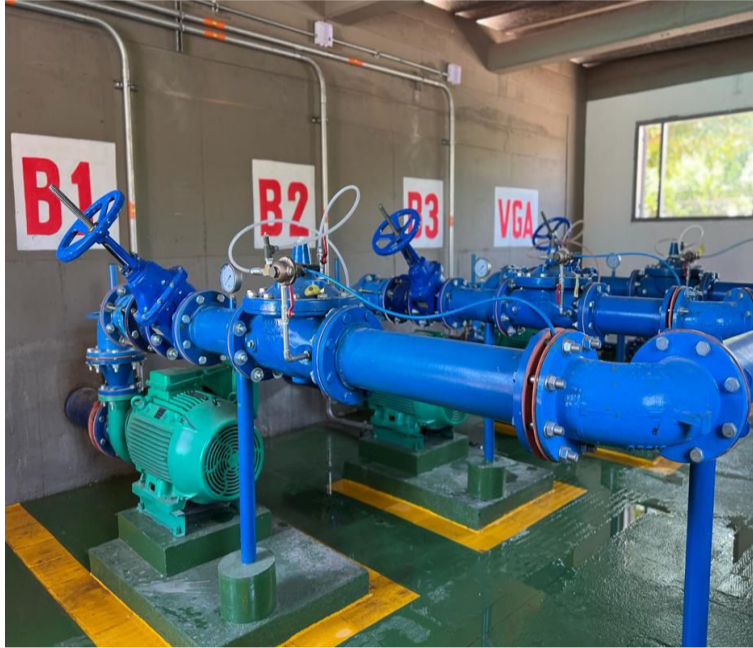
Las obras realizadas permitirán mejorar la frecuencia, continuidad y cobertura a los usuarios conectados.
